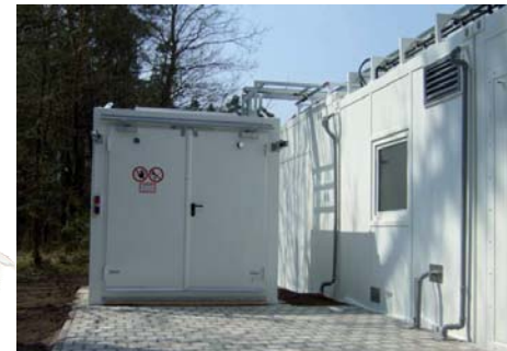
Geschützter Prüfcontainer für Untersuchungen an Traktionsbatterien
