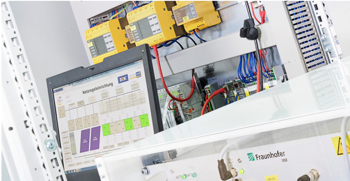
Gleichspannungsmodul des modular aufgebauten intelligenten Energieknotens (leK) mit Netzregelung (DC-Gridmanager des Fraunhofer IISB) und Wechselrichtern. Bild: Anja Grabinger / Fraunhofer IISB
